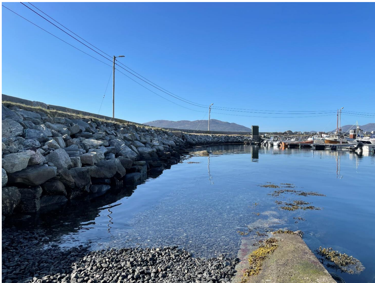
Figur 13 Foto 4 av moloens kortsider inn mot havna. Blokkene er mindre enn på sjøsiden og skråningen ser fin ut.
