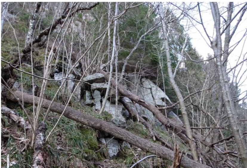
Figur 19. Avløste blokker i nedre del av bergskråning i nordøst. Bildet er tatt mot øst (foto).
