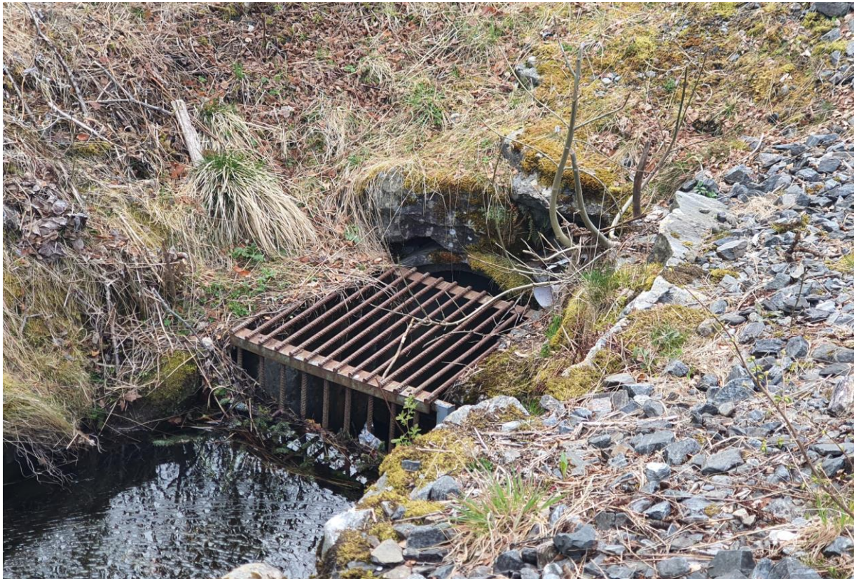
Figur 19: Observert stikkrenne/rist tilknyttet «Kattagrova».
